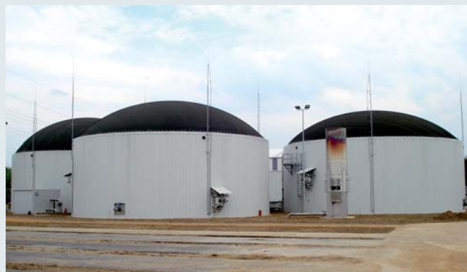
Биогазовая установка на природном газе в г. Керпен. Защита камеры ферментации – молниеприемники с токоотводом HVI
