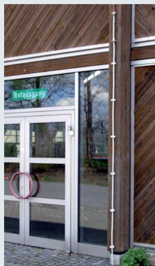
Рис. 6. Применение безопасного токоотвода CUI вблизи входа в здание
